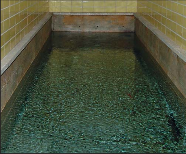
Quellfassung Forstbrunnen hinter dem Pumpwerk Enge
